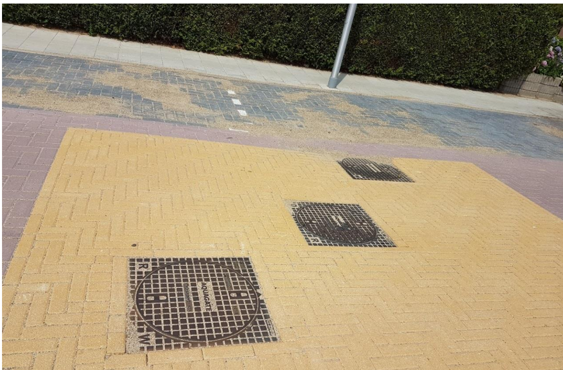
Figuur 16 Als er drainage wordt aangelegd komt er een extra leidingnet. Dit is te herkennen aan de putdeksels voor vuilwater, hemelwater en drainage.
