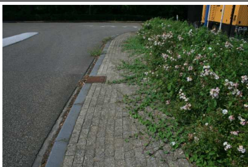
De Nort / Parallelweg – onkruid kruipt vanuit het plantvak de elementenverharding op en vindt daar genoeg plekken om te wortelen.
